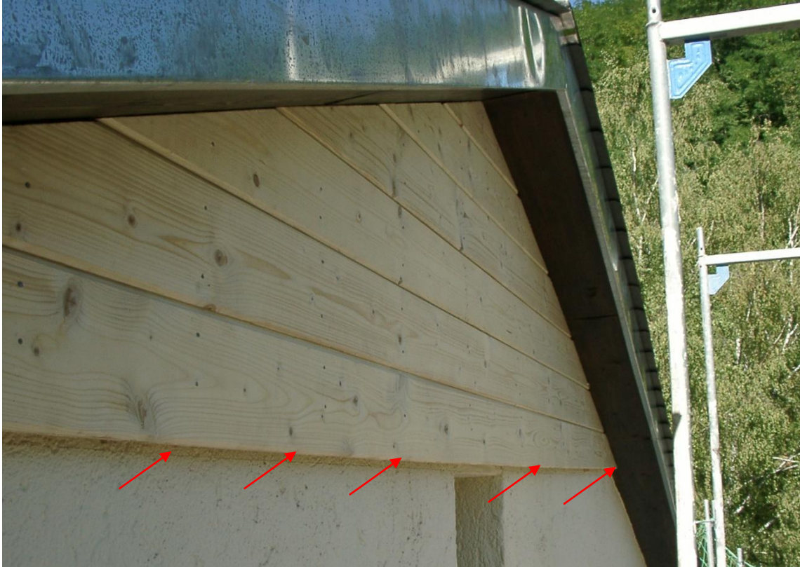
Abb. 3: Hier mit Nut-Federbrettern verschalt, die Einflugbereiche befinden sich in bestimmten Abständen (etwa 100cm) unter dem Abschlussbrett (Pfeil) in einer Ausprägung von jeweils 20cm. Somit sind mindestens 6 Öffnungen im Bereich der waagerechten Latte am Abschlussbrett vorzusehen. Die Fledermäuse landen am rauen Putz und krabbeln hinter die Nut-Federbretter, die Einflüge müssen somit bündig mit dem Putz bzw. der Fassade verlaufen und dürfen keine Stufen aufweisen!
