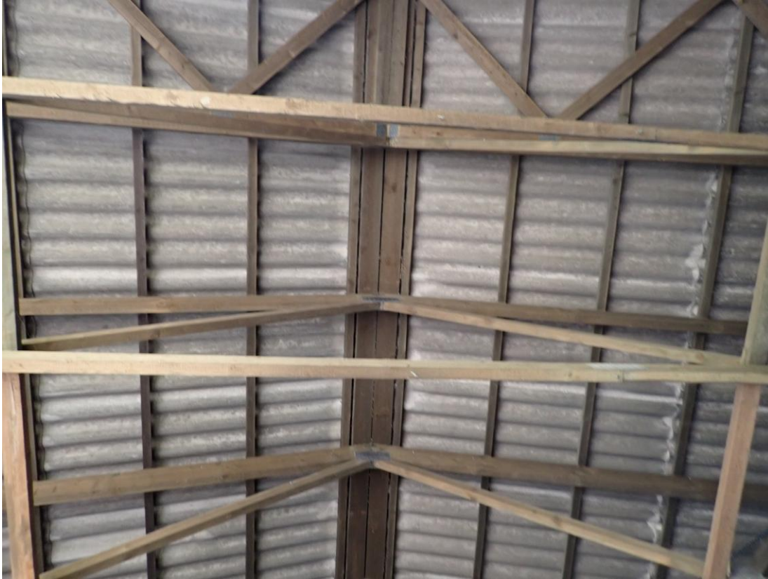
Abb. 17: Spalten im First mit Nistmaterial vom Haussperling und sich darunter befindlicher Kot der Langohrfledermaus.
