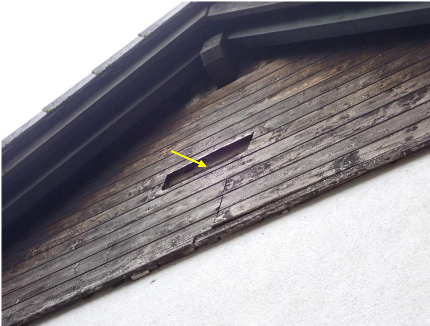
Abb. 6: Einflugspalt in den Dachstuhl für Dachstuhlflodermäuse, sowie Fassaden-Giebelverschalung für spaltenbewohnende Arten.
